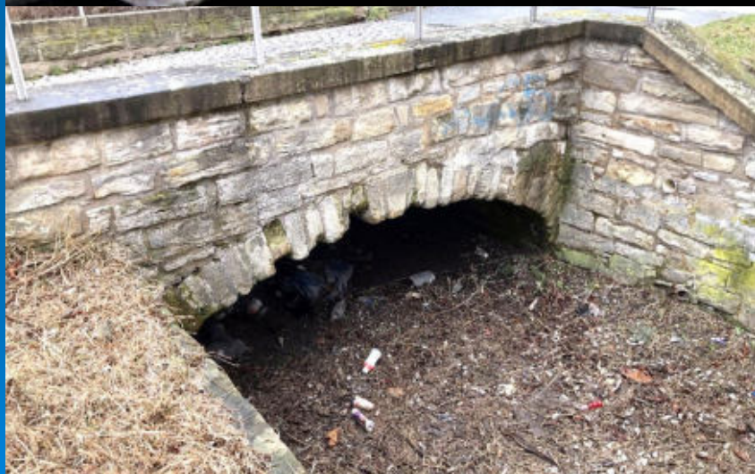
Zeitz: Älteste Brücke über den Floßgraben in Sachsen-Anhalt von 1696 (An der Hohle)
